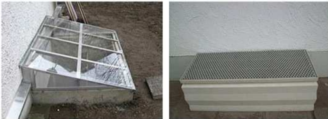
Abbildung 19: Beispiel: Sicherung von Kellerfenstern und Lichtschächten
